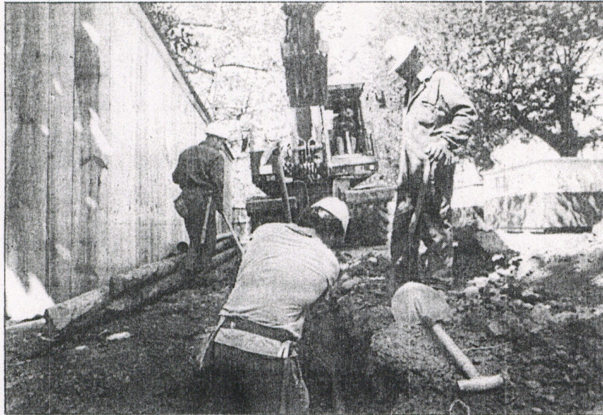
Los populares aseguran que la continuación de las obras «vulnera la legalidad»
